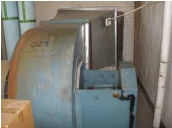
Fig. 2.4.A.11 - Toilet Exhaust Fan
