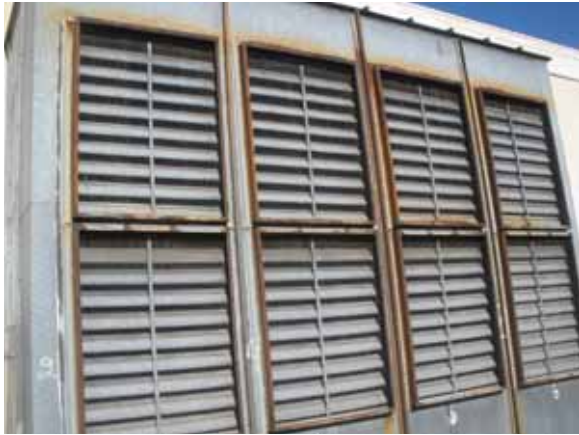
Fig. 2.4.A.10 - OA Intake Louvers
